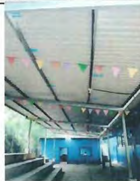
Foto 8: El patio del establecimiento no cuenta con la iluminación necesaria, por lo que se sustituirán algunas laminas por lamiluz para obtener mejor iluminación.
