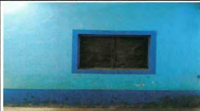
Foto 3: En difentes areas la pintura de la escuela se encuentra deteriorada.
