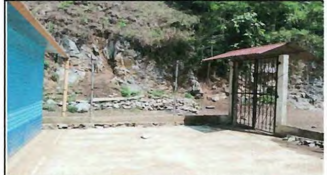
Foto 4: La circulación con la que cuenta el establecimiento se enuentra dañada.
