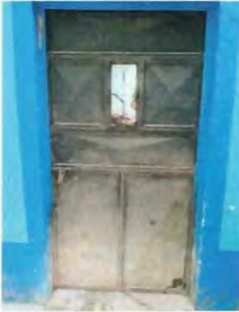
Foto 1: Las diferentes puertas del establecimiento se encuentran en mal estado y presentan oxido en diferentes areas.
