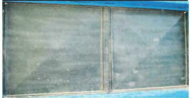
Foto 2: Las diferentes ventans del establecimiento se encuentran en mal estado y presentan oxido en diferentes areas.
